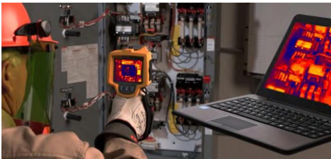
Рисунок 20. Пример проведения тепловизионного контроля электрошкафа
